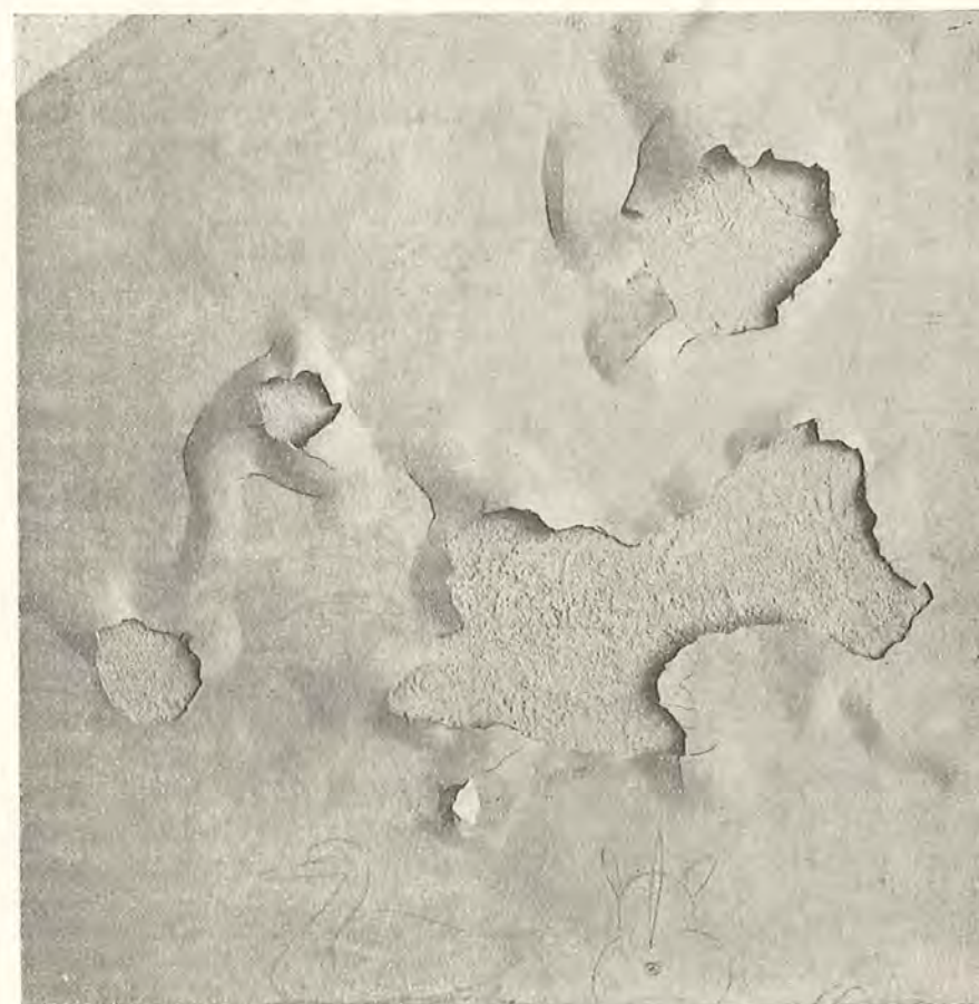
Fig. 11. Indermur med afskallende Finpuds fremstillet af hydraulisk Kalk + fint Sand, R_k : R_s = 2 : 1 . Afskallingen begyndte 2 Uger efter Pudsningen. En Undersøgelse viste, at Kalken indeholdt 15% Korn > 0,09 mm. Et Provelegeme fremstillet alene af disse Korn + Vand sprængtes inden et Døgn som Følge af Kornenes Efterlæsning.
